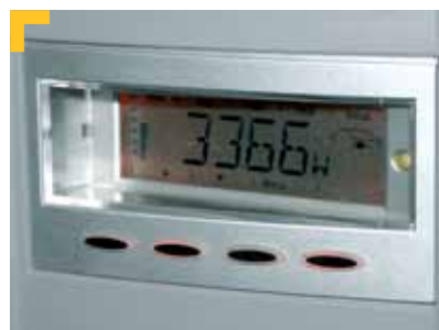
Il monitor sull'inverter permette di verificare in ogni momento la quantità di elettricità prodotta
